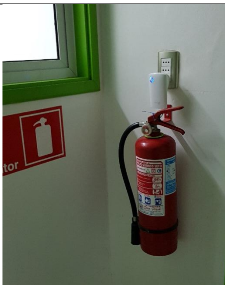
Extintor N°2: exterior Cocina y Sala de amamantamiento primer piso
