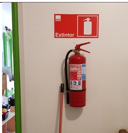
Extintor N°3: hall Sala Cuna segundo piso
