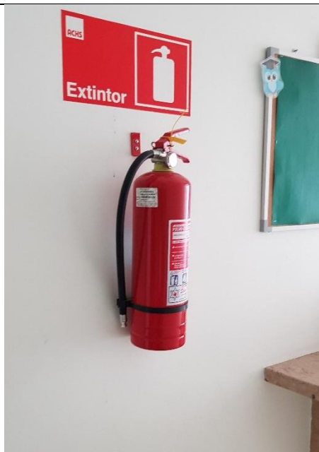
Extintor N°1: pasillo Niveles medios primer piso
